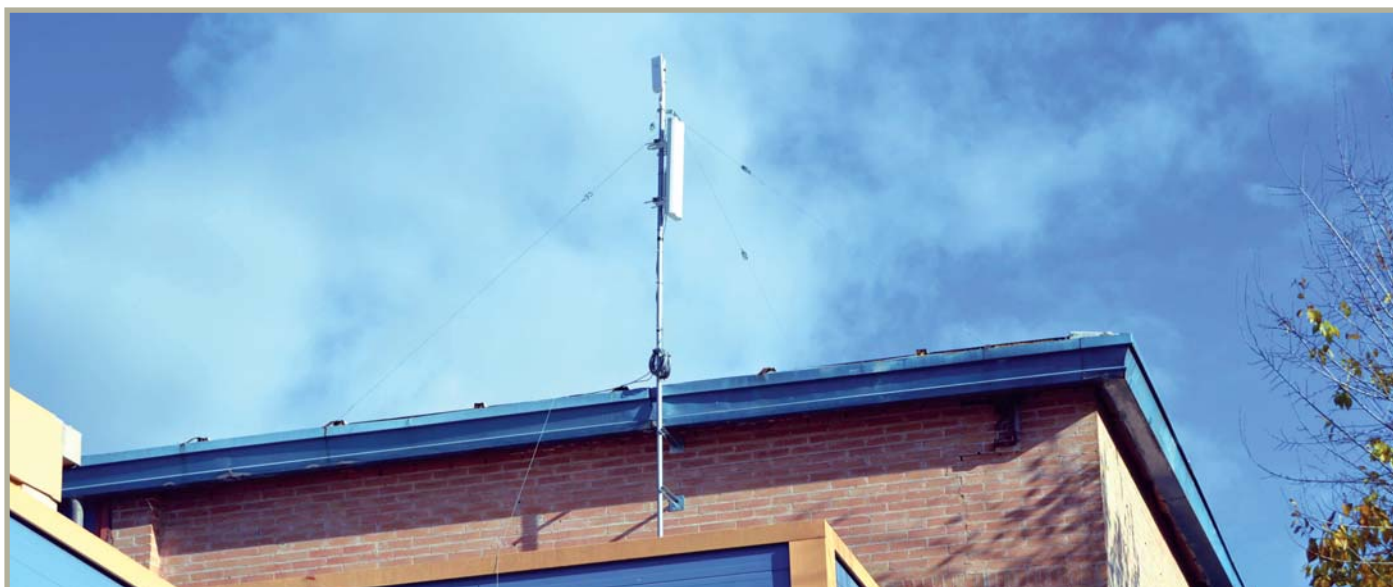
Antena wifi en el pabellón
